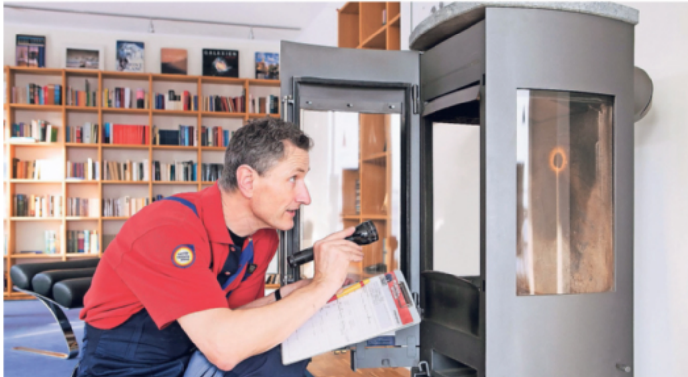
Eine Prüfung durch den Schornsteinfeger ist oft dringend notwendig. Die üblichen Kehr-, Mess- und Prüfarbeiten dürfen auch Betriebe aus dem Bereich Sanitär, Heizung und Klima übernehmen, wenn sie eine entsprechende Qualifikation haben.
